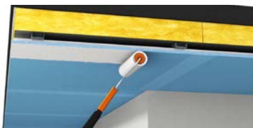
Nach einer weiteren Trocknungszeit von ca. 2 Stunden folgt das satte Vorlegen einer entsprechenden Farbschichtung (beispielsweise „Keim Soldalit“ Silikat-Fassadenfarbe).
