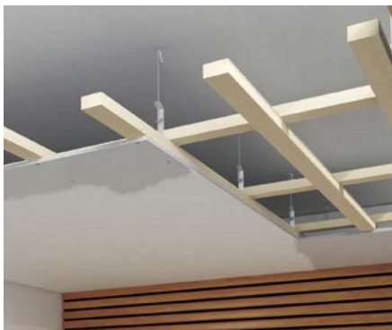
Abgehängte Unterdecke im Nassraum-oder Außenbereich mit zementgebundenen Powerpanel H 2 O Platten und Powerpanel Malervlies
